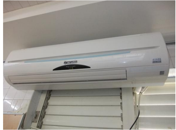
社區中心新增冷氣機
