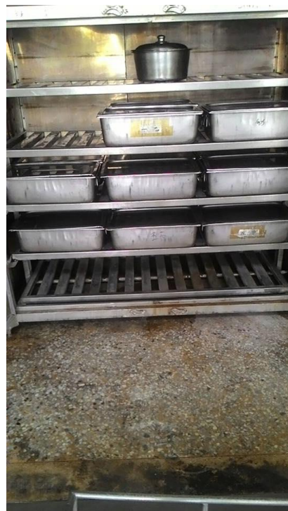
蒸飯箱運運鍋爐產生的蒸氣煮食
