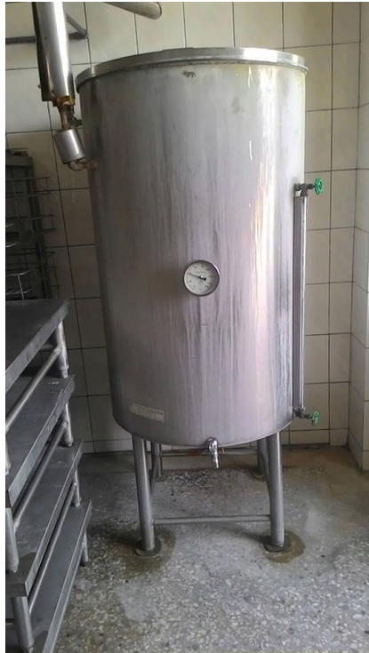
運用廚房鍋爐蒸氣煮開水
