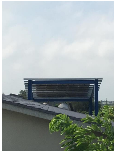
本校大勇樓屋頂閒置空間設置有太陽能板發電設備
